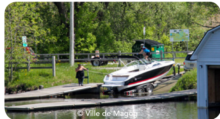
Endommagement des passerelles de bois et les rampes de mise à l'eau
